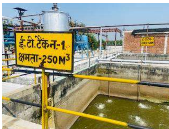
Pic : 2 ETP tank
